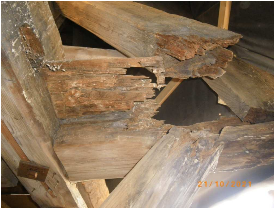
Massive Schäden an der Tragkonstruktion der Turmhaube
