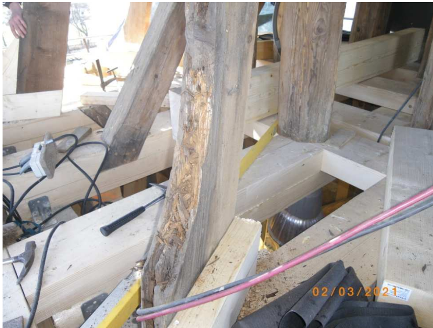
Schaden Schweißsparren und neue Decke Laternenhaube
