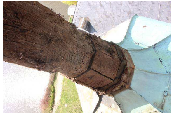
Sichtbare Schäden der Holzkonstruktion über dem Turmhelm
