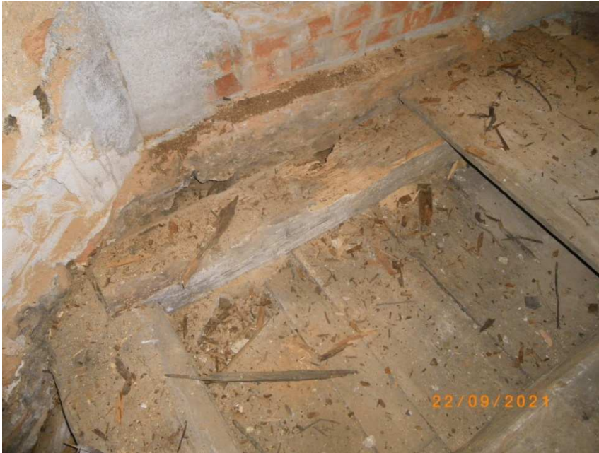
Schaden am Deckenbalken nach Öffnung der Diele
