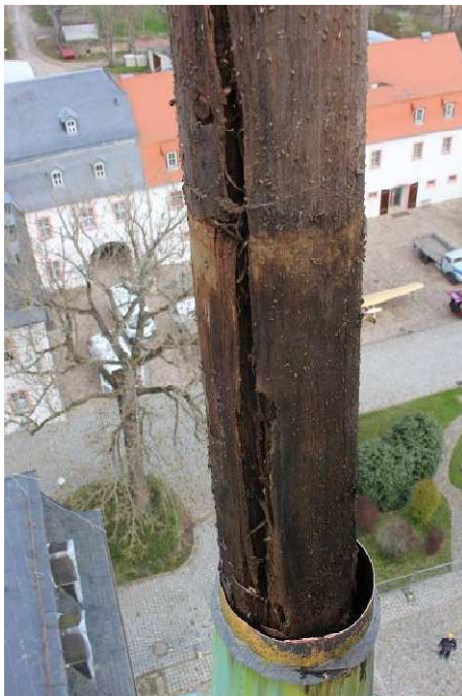
Geschädigter Kaiserstiel nach Abnahme Verblechung und Kugel
