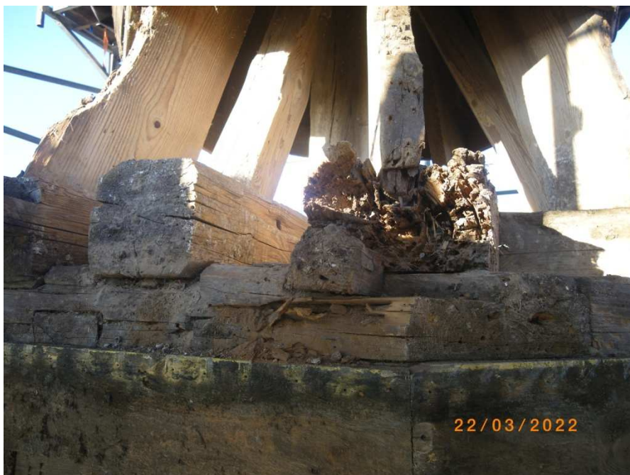
Schäden im Bereich oberer Turmhelm
