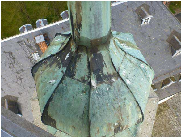
Undichte angerostete Dachkonstruktion des oberen Turmhelmes
