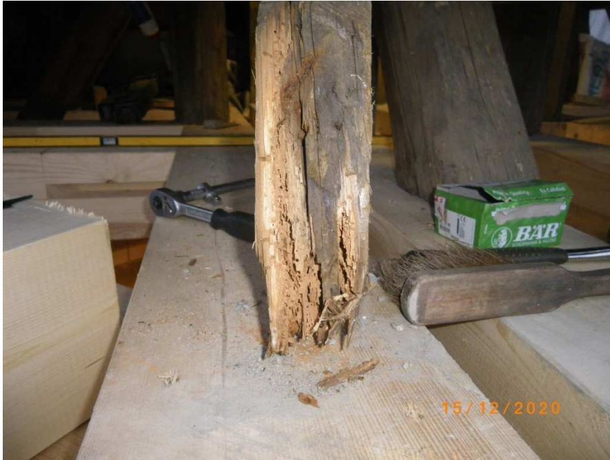
Schadhaftes Holz nach Ausbau im Bereich Turmhaube
