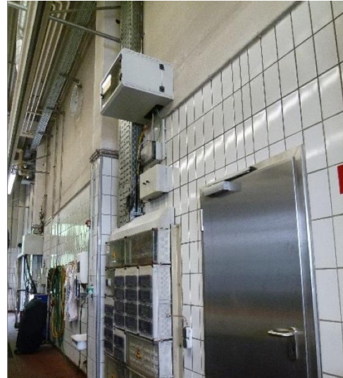
Ebenda, Steuerung und Zugang Dieselzapfanlage
