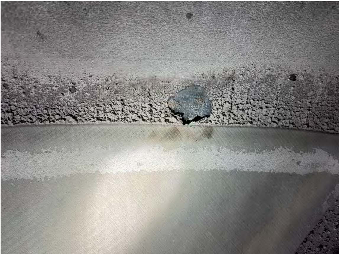
Bild 7 Innenansicht, Abblätternde Gummierung im Wandbereich
