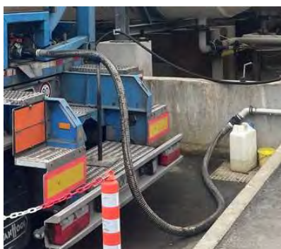
Abbildung 1 - Beispielfoto - Anschluss eines Tankfahrzeuges an eine Rohrleitung
