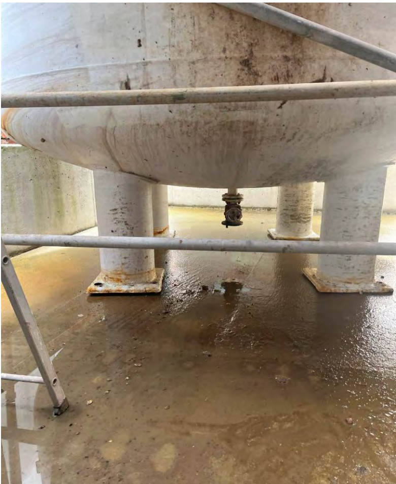
Bild 3 Gummierter 25m³ Behälter, Außenansicht, Füße und Bodenventil
