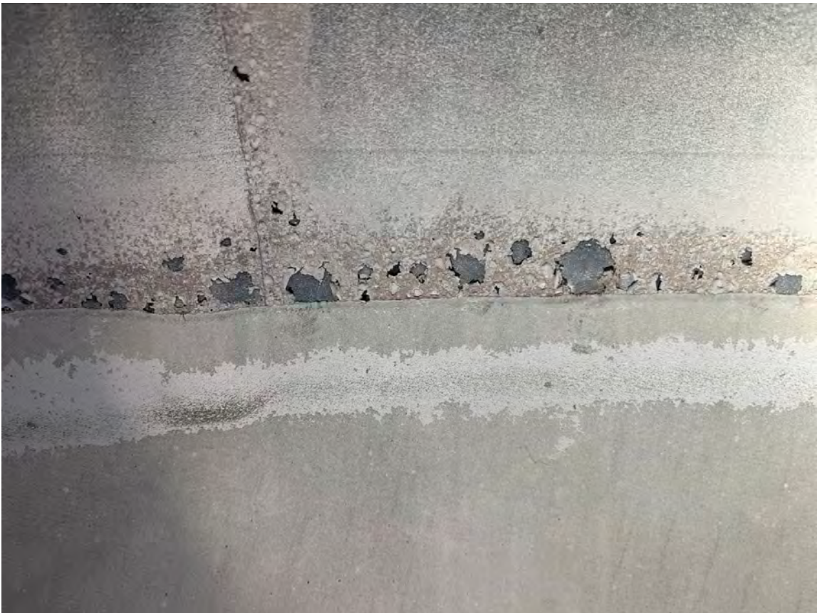
Bild 8 Innenansicht, Abblätternde Gummierung im Wandbereich
