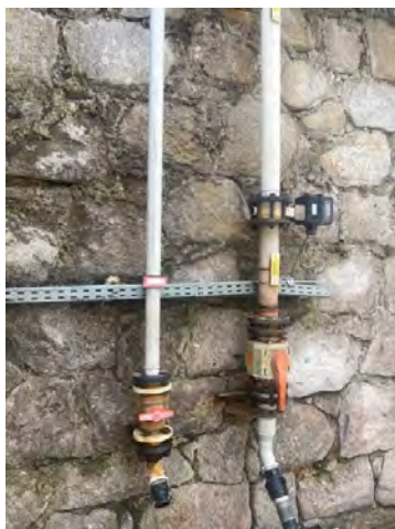
Abbildung 2 - Bauseits vorhandene Anschlussstellen für die Befüllung mit \text{FeCl}_3 und \text{HCl}
